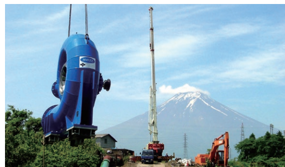
2004年 | 山一産業水力発電所（フランス水車）
